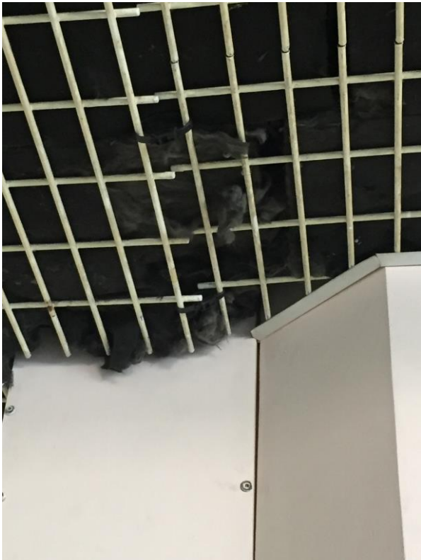
Photo 3 (poussière au plafond)
